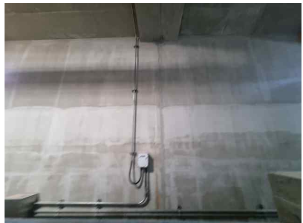
<1~2호지 유입밸브실 벽체 신축이음부 열화>
