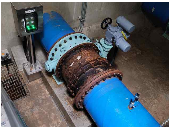
<유입배관실 배관설비 관부식>
