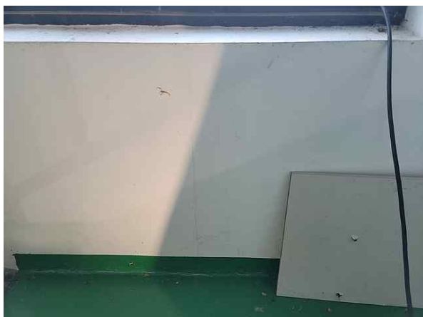
<펌프실 지상1층 벽체 망상균열>
