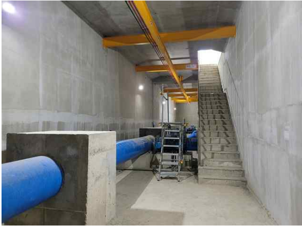
<3~4호지 유입밸브실 전경>
