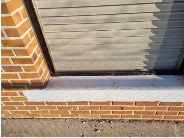
<1~2호지 검수실 외부 균열(0.3mm미만)>
