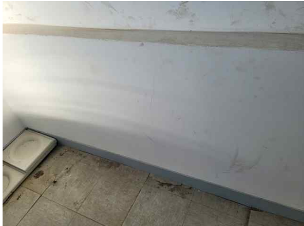
<전기실 내부 균열(0.3mm미만)>
