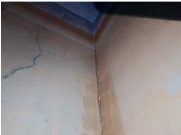
<배수지 2지 벽체 균열부백태>
