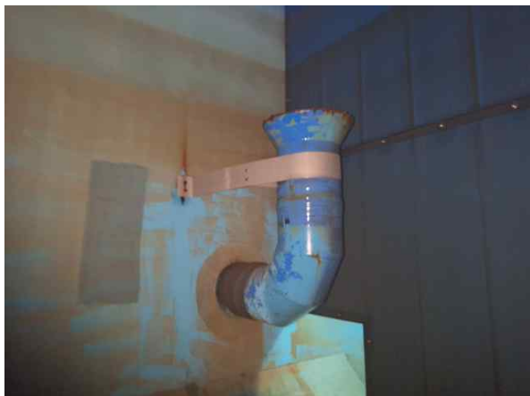
<배수지 2지 유입배관 부식>
