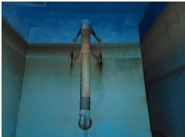
<배수지 3지 유입배관 부식>
