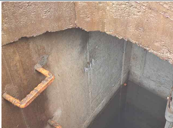
<송수-3 Sta.12+0.0(이토) 벽체 백태 발생(3EA)>
