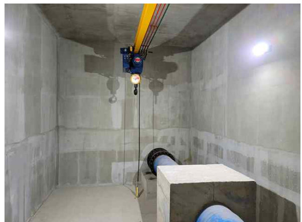
<3~4호지 유입밸브실 호이스터 상태양호>
