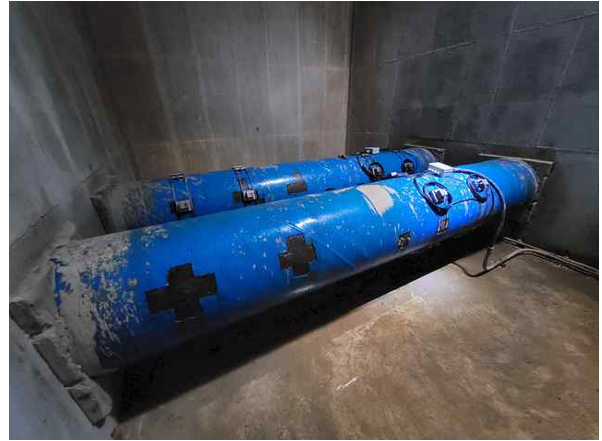
<유량계실 내부 전경>
