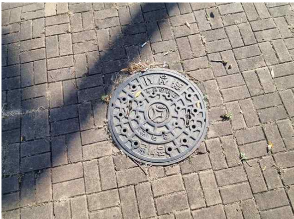
<송수-1 공기밸브실 맨홀 덮개 상태양호>
