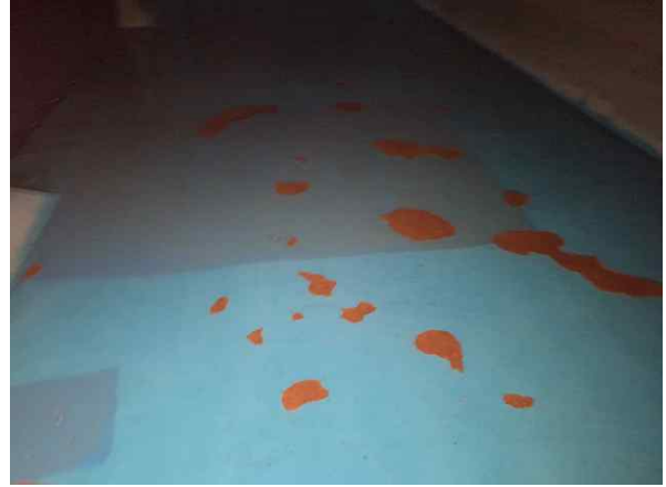
<배수지 2지 바닥슬래브 도장박리>
