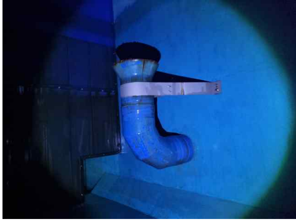
<배수지 1지 유입배관 부식>
