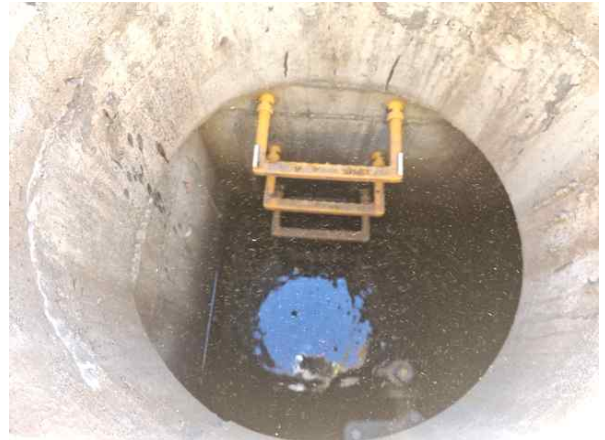
<송수-1 Sta.48+15.0(공기) 밸브실 침수(H=0.3m)>
