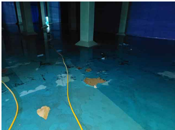
<배수지 1지 바닥슬래브 도장박리>
