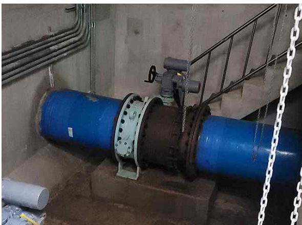
<배관실 유입밸브 상태양호>
