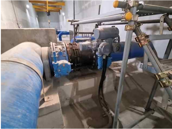
<기계설비(1~2호지 밸브 및 배관) 전경>
