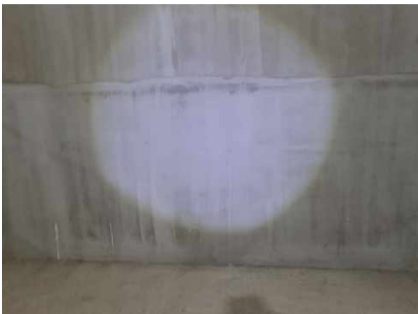
<1~2호지 유입밸브실 벽체 균열부백태>
