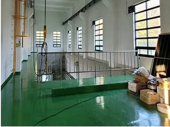
<펌프실 지상1층 안전난간 상태양호>
