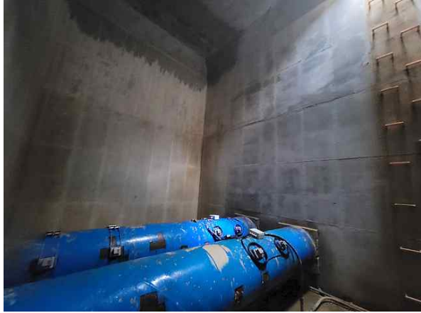
<유량계실 내부 상태양호>
