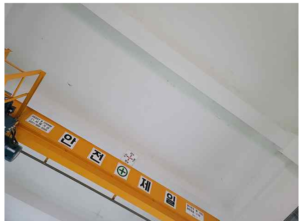
<펌프실 지상1층 상부슬래브 망상균열>
