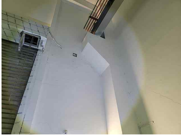
<펌프실 지상1층 벽체 균열, 누수흔적>
