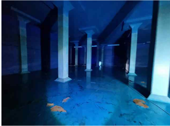
<배수지 1지 전경>
