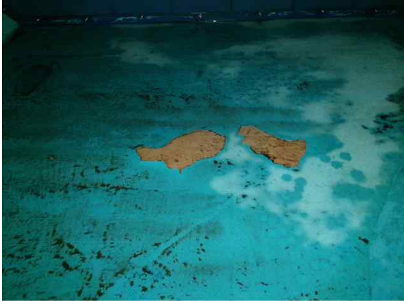
<배수지 4지 바닥슬래브 도장박리>
