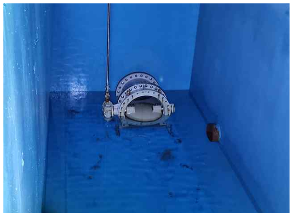
<저류지 유출 수동밸브 상태양호>
