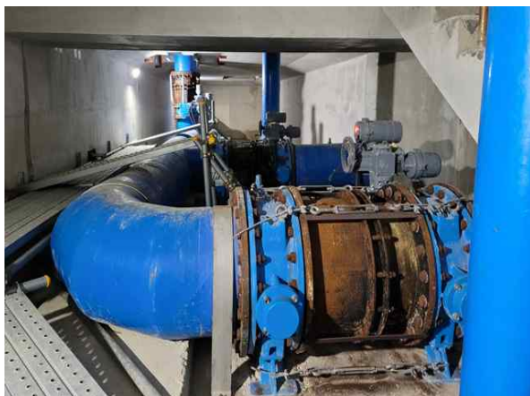
<3~4호지 유출 밸브, 배관, 볼트류 상태양호>
