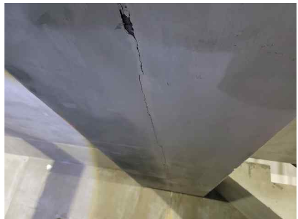
<3~4호지 유출밸브실 상부슬래브 균열>
