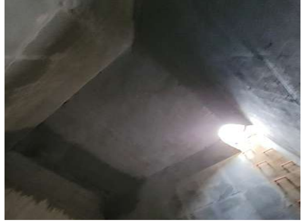
<유량계실 내부 상태양호>
