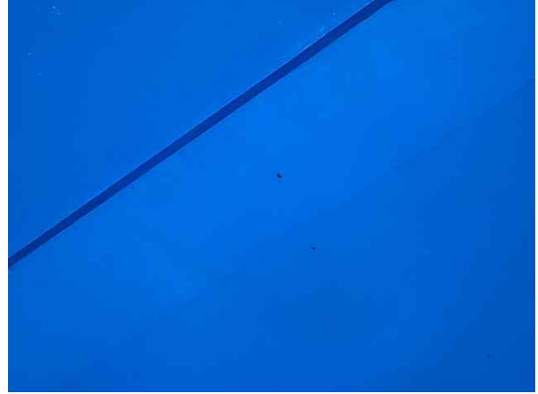
<배수지 2지 상부슬래브 녹 발생>
