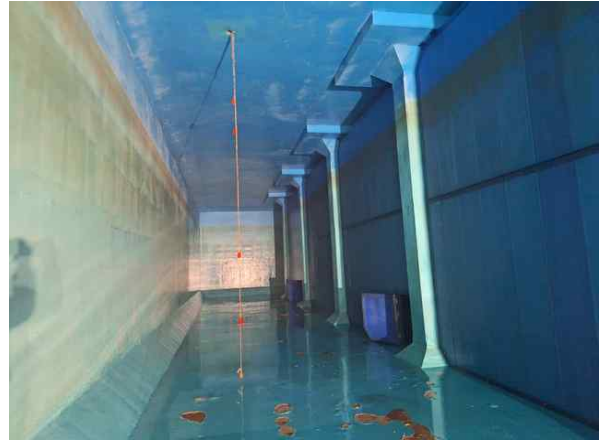
<배수지 2지 전경>
