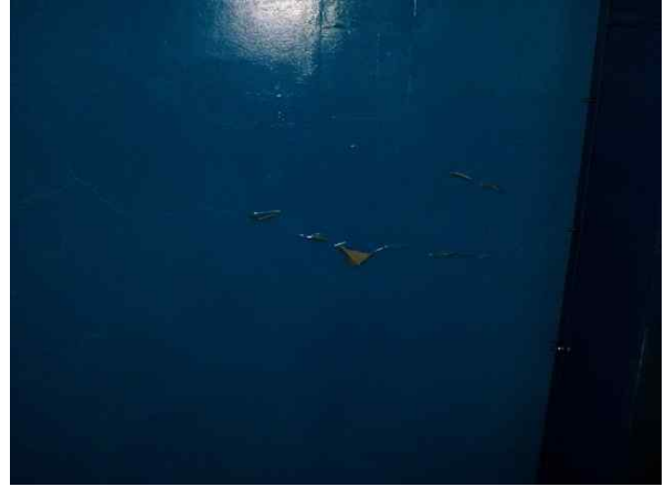
<배수지 4지 상부슬래브 도장박리>
