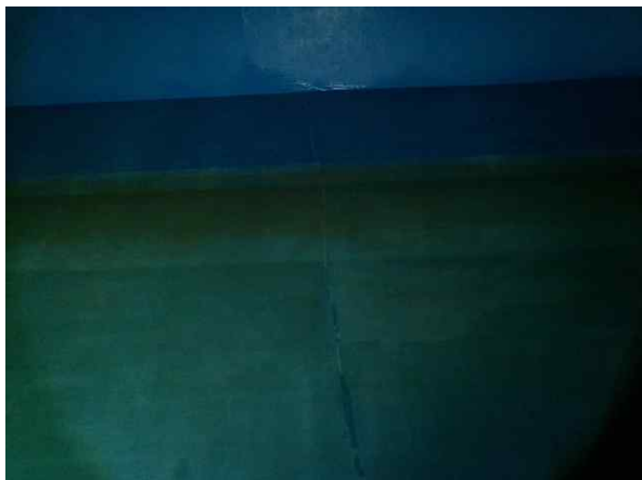
<배수지 4지 벽체 균열부백태>
