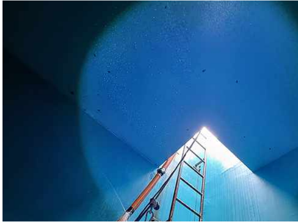
<배수지 1지 상부슬래브 균열/백태>
