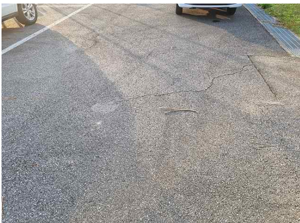
<장내포장 아스콘 균열>
