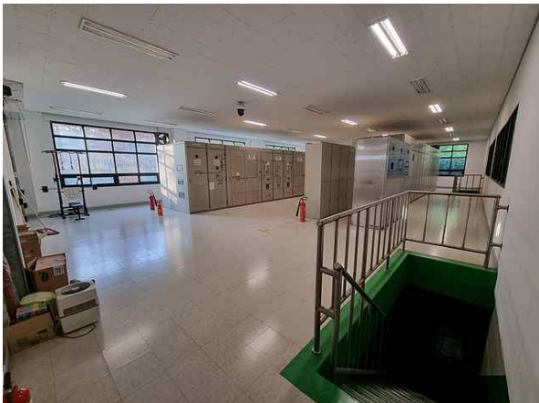
<전기실 내부 전경>
