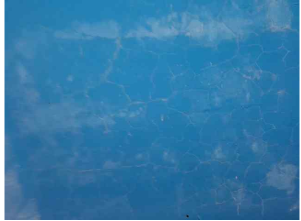
<배수지 2지 상부슬래브 균열부백태>
