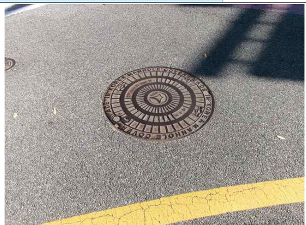
<송수-5 Sta.26+11.0(제수) 맨홀 뚜껑 고착으로 인한 인력개폐 불가>
