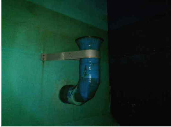
<배수지 4지 유입배관 부식>
