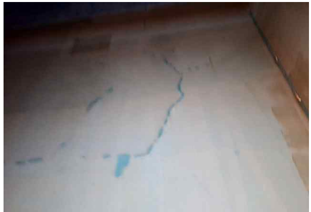
<배수지 2지 벽체 보수부 재균열>
