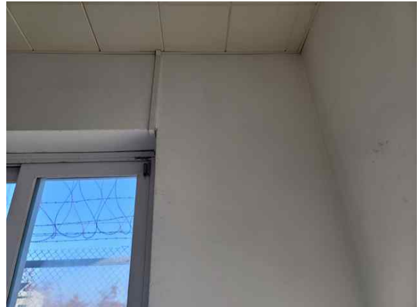
<전기실 내부 균열(0.3mm미만)>
