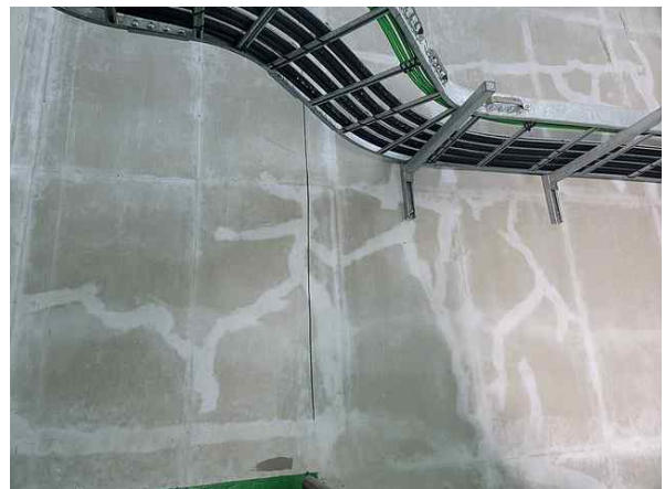
<펌프실 지하 내부벽체 망상균열>
