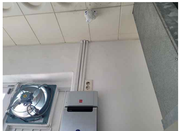
<전기실 내부 균열(0.3mm미만)>
