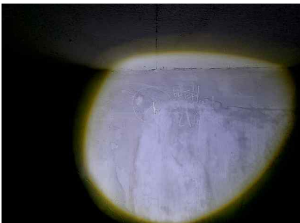
<유출배관실 벽체 균열>
