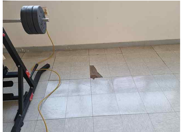
<전기실 바닥슬래브 타일박락>
