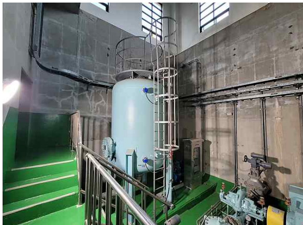
<펌프실 지하 설비 전경>
