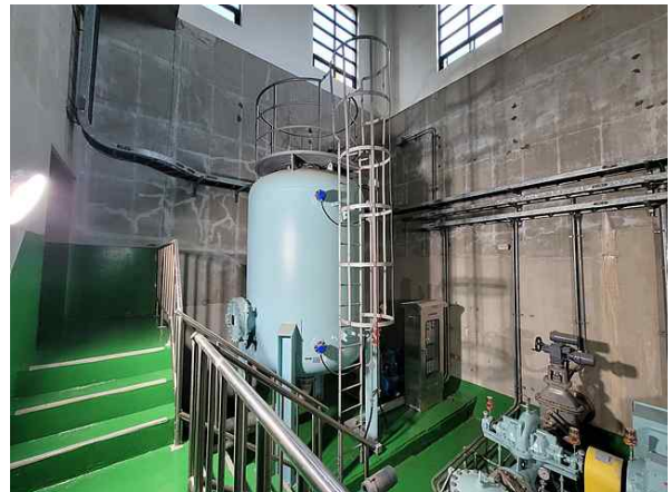
<펌프실 지하 내부 전경>
