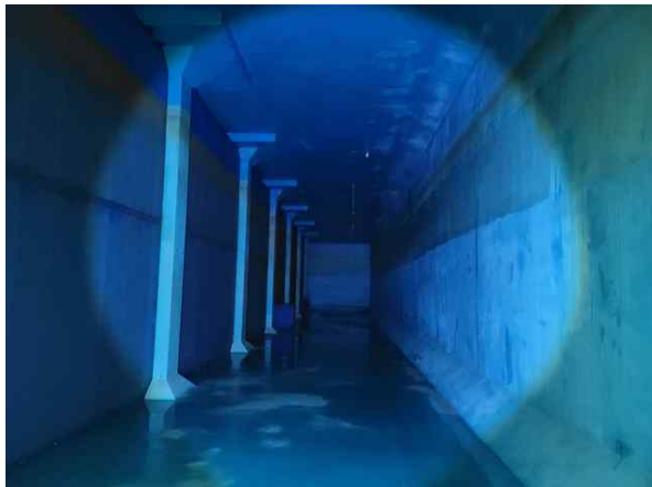
<배수지 3지 전경>
