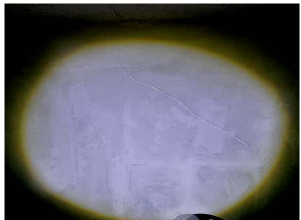
<유출배관실 벽체 균열>
