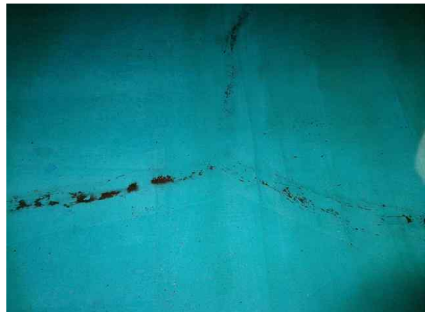
<배수지 4지 바닥슬래브 균열>
