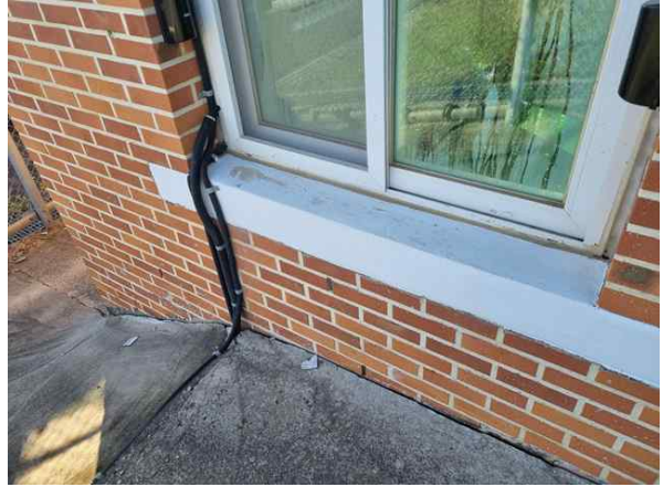
<1~2호지 검수실 외부 균열(0.3mm미만)>
