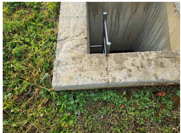
<유입배관실 입구부 균열>
