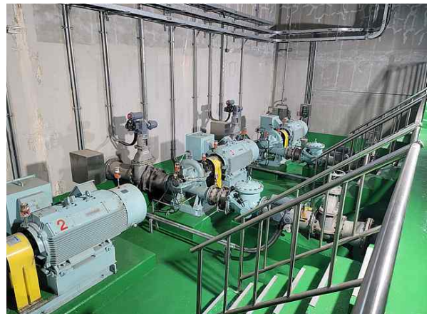
<펌프실 지하 설비 전경>
