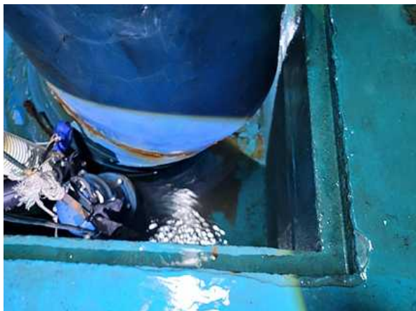
<배수지 2지 바닥슬래브 도장박리>
