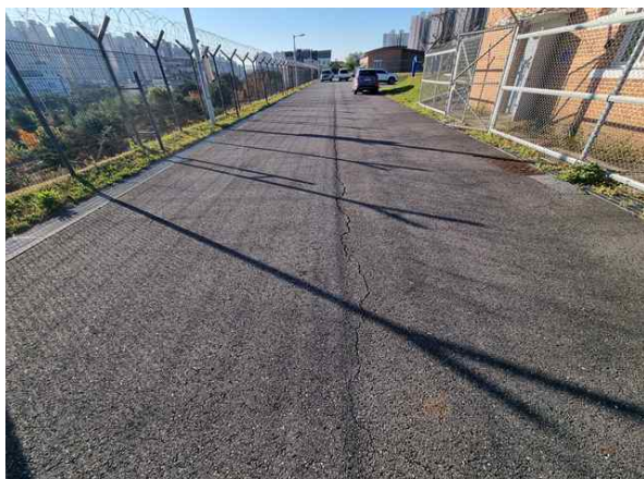
<장내포장 아스콘 균열>
