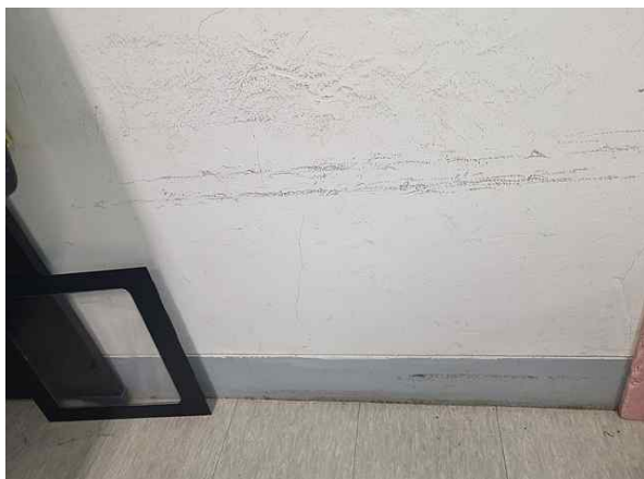
<사무실 벽체 몰탈균열>
