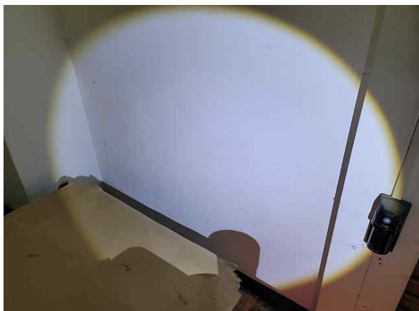
<펌프실 지상1층 벽체 몰탈균열>
