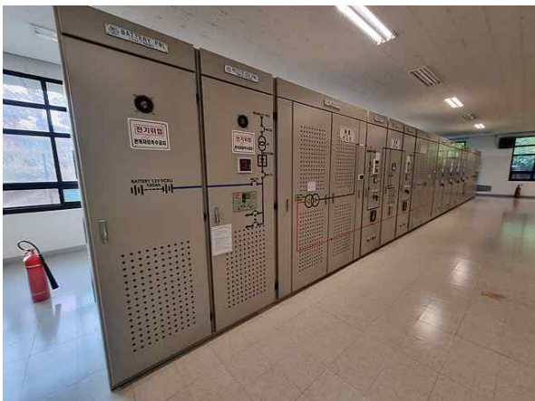
<전기실 수변전설비 상태양호>
