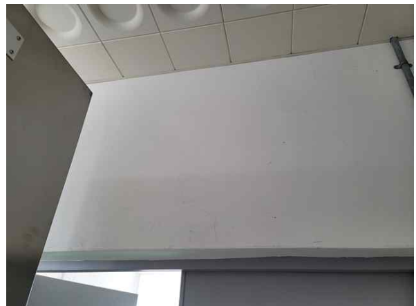
<3~4호지 검수실 내부 균열(0.3mm미만)>
