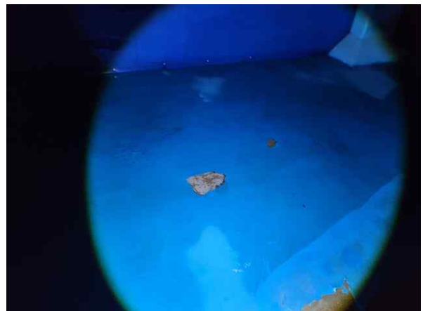
<배수지 3지 바닥슬래브 도장박리>
