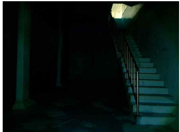
<배수지 4지 전경>
