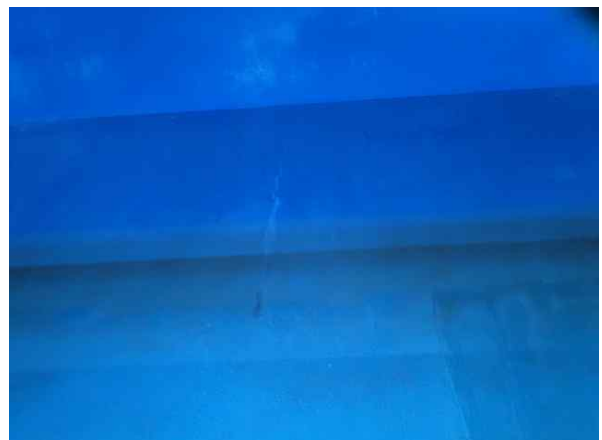
<배수지 3지 벽체 균열부백태>
