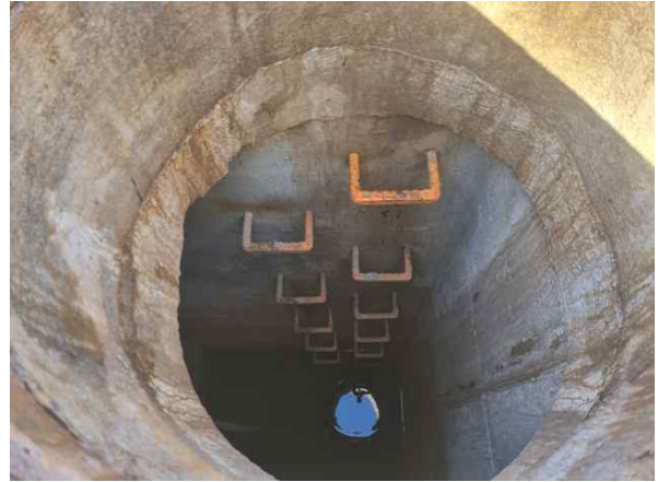
<송수-1 이토밸브실 사다리 설치 상태양호>
