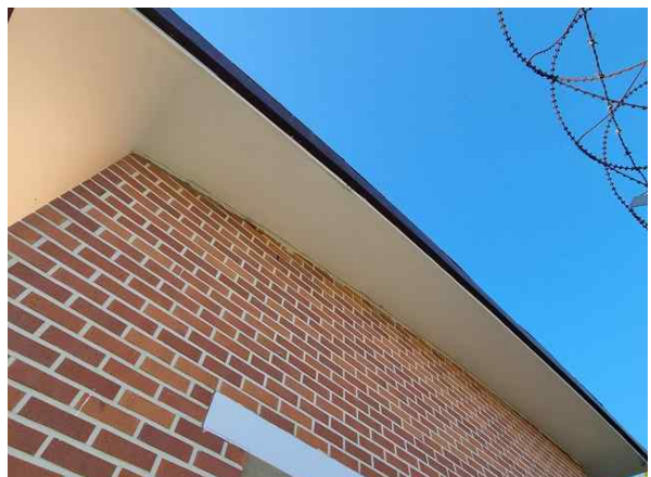
<3~4호지 검수실 외부 균열(0.3mm미만)>
