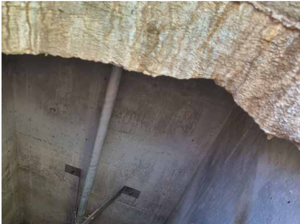
<송수-1 Sta.7+6.35(이토) 상부슬래브 콘크리트 파손>
