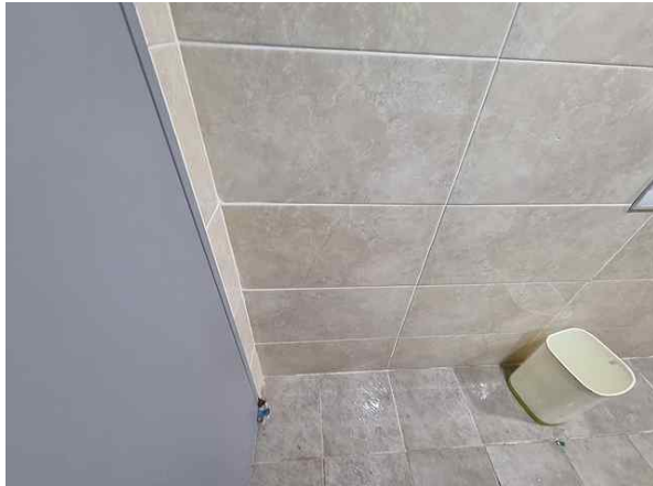
<화장실 벽체 타일균열>
