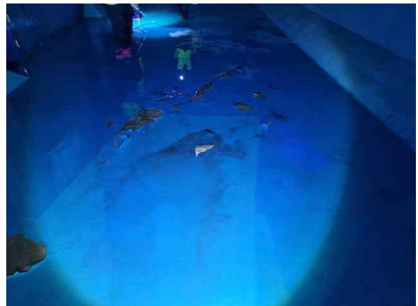
<배수지 1지 바닥슬래브 도장박리>
