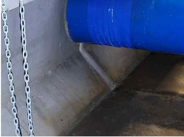
<유입배관실 벽체 균열부백태>
