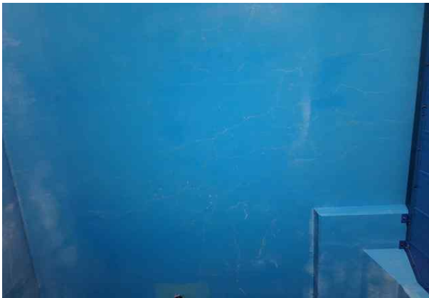
<배수지 2지 상부슬래브 망상균열>
