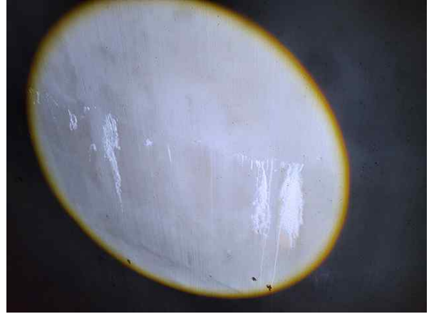
<유입배관실 벽체 균열부백태>
