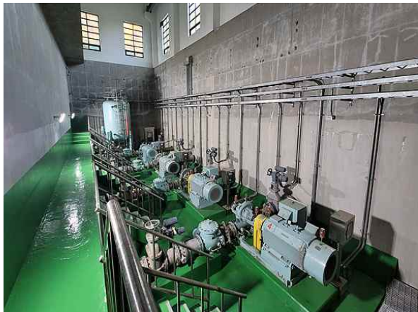
<펌프실 지하 내부 전경>
