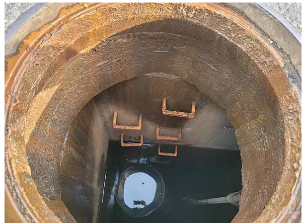
<송수-3 이토밸브실 사다리 설치 상태양호>
