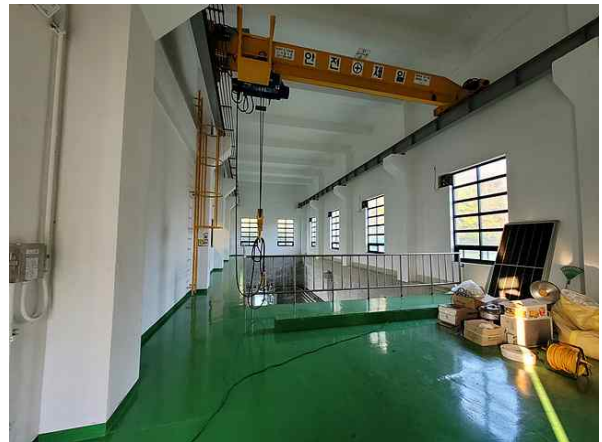
<펌프실(지상) 내부 전경>
