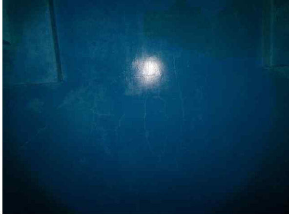
<배수지 4지 상부슬래브 균열부백태>
